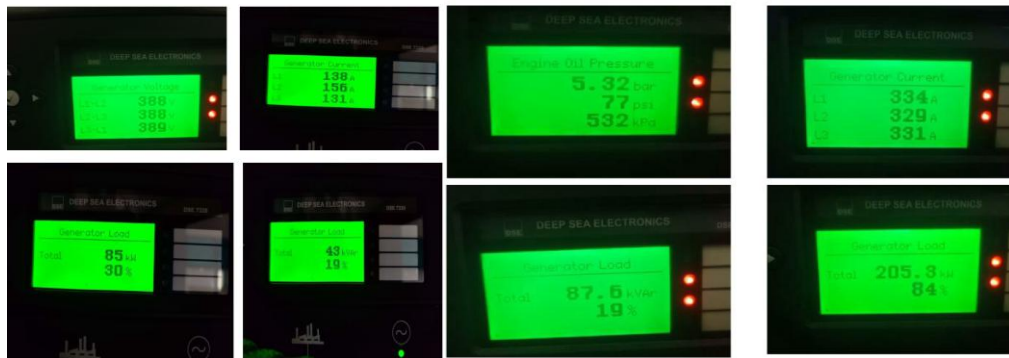
Gambar 3. Nilai uji beban genset (85 kw/30% dan 205,3 kW/84%)
