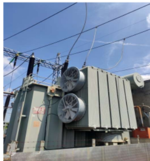
Gambar 4 Transformator IBT Daya 100 MVA
