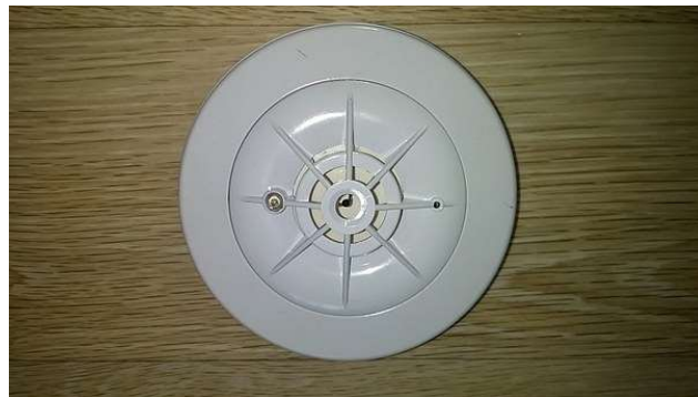
Gambar 3. Smoke Detector (Sumber pribadi)
