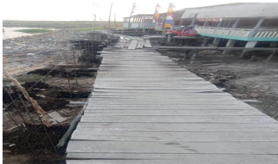
Gambar 1. Kondisi jalan desa di Desa Tulung Selapan Ilir sebelum dilakukan perbaikan Sumber : Dokumentasi Pemerintahan Desa, 2024.
