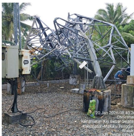
Gambar 2. Kerusakan Struktur Tower
