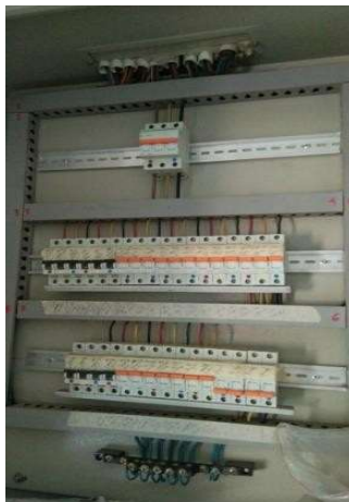
Gambar 6. Panel Cabang Lantai Dasar.
