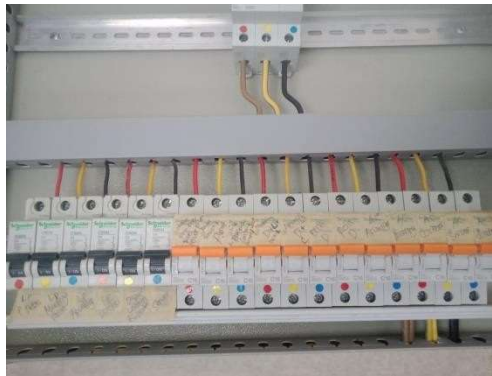
Gambar 5. Panel Cabang Lantai Atas
